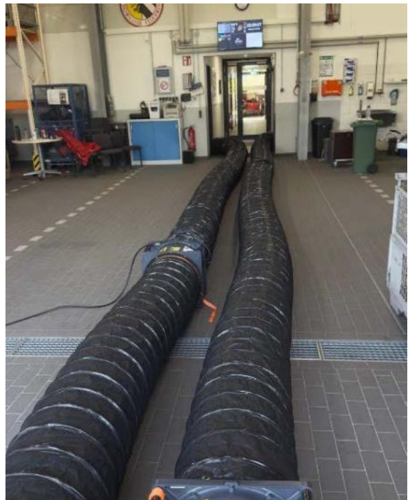
Be- und Entlüftungsgerät mit Lutte
