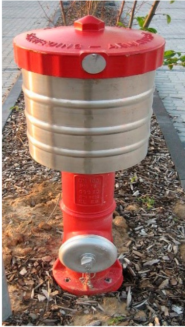
Überflurhydrant mit Fallmantel
