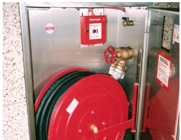
Wandhydrant im Kaufhaus mit Druckschlauch-W
