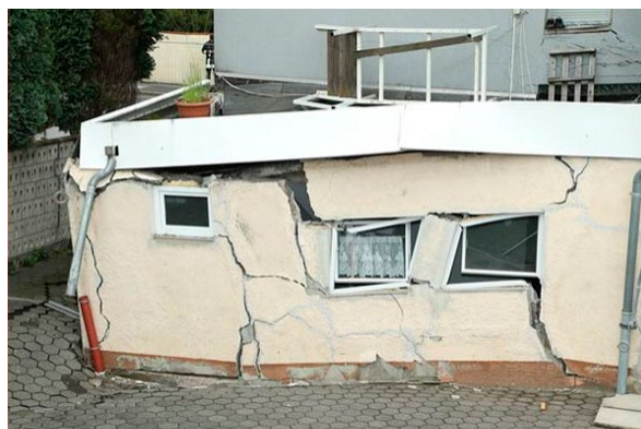
Abb. 5+6: zunehmende Schäden an einem Gebäude durch Absacken (Fotos: Feuerwehr Dortmund)
